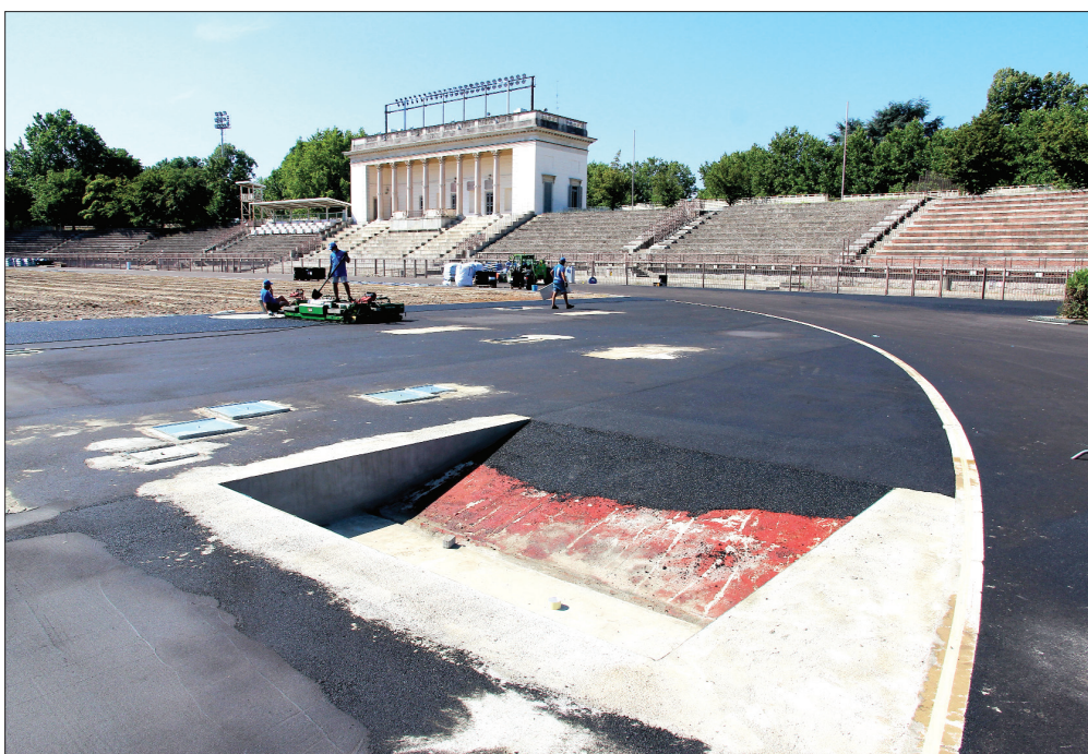
In alto, pianta della pedana per il salto in lungo/triplo. Al centro, sezione della fossa siepi riconfigurata; in basso a sinistra, la fossa durante i lavori nella fase di stesura del binder. A destra, il rettilineo est con la pedana del salto.
